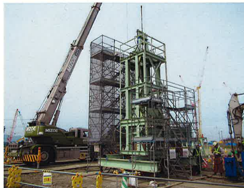
ポンプ室（急速載荷試験）
